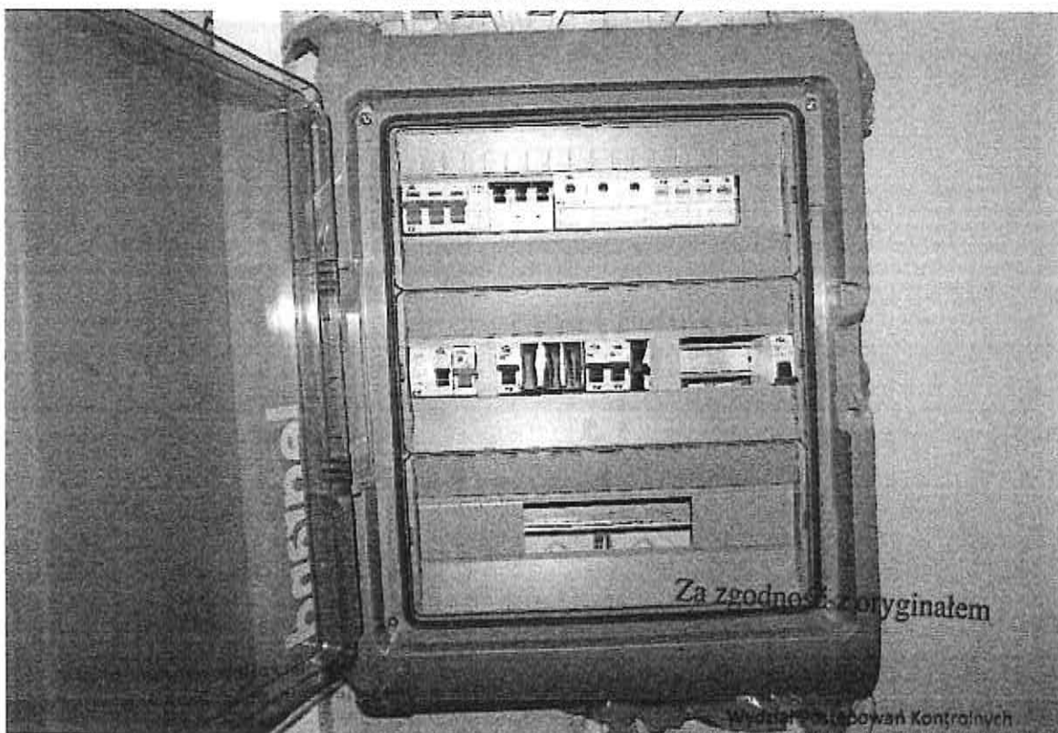
Fot.50. Tablica elektryczna piętro
