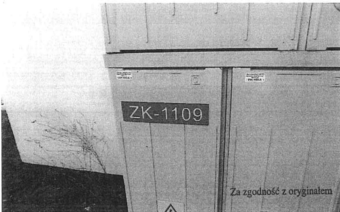
Fot.74. Złącze kablowo pomiarowe budynku
